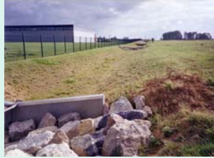
Noue permettant la récupération des eaux pluviales
